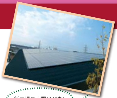
新工場の太陽光パネル
