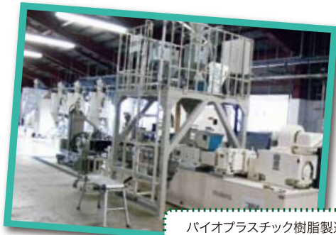
バイオプラスチック樹脂製造の「混練プラント」
